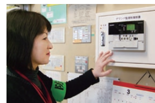
デマンドコントローラー
