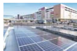
太陽光パネルを設置
