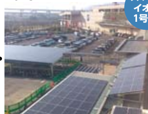
「イオンモール八幡東」(福岡県) エネルギーの「見える化」により、 “まちぐるみ”でのエネルギー削減に 貢献していきます。
