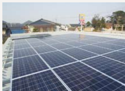
太陽光パネル
