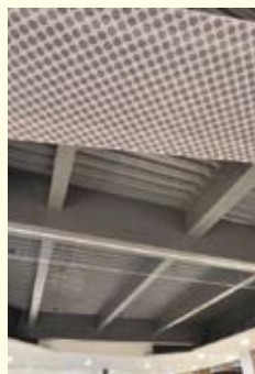
天井の耐震性をより強化し、モールのメイン通路の大部分を「スケルトン天井」とすることで、落下物を未然に防止
