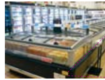
自然冷媒による冷凍ケース
