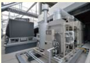
自家発電設備(コージェネレーションシステム)や長時間対応型非常用発電機を設置
