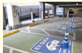
電気自動車(EV)の充電器を全14台設置
