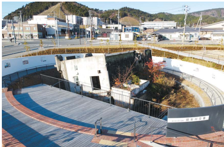
震災遺構として残された旧女川交番。津波の引き波で基礎のコンクリート杭から横倒しになった。津波のエネルギーの凄さを物語る。「ぜひ残してほしい」という中学生の声で遺構となった
