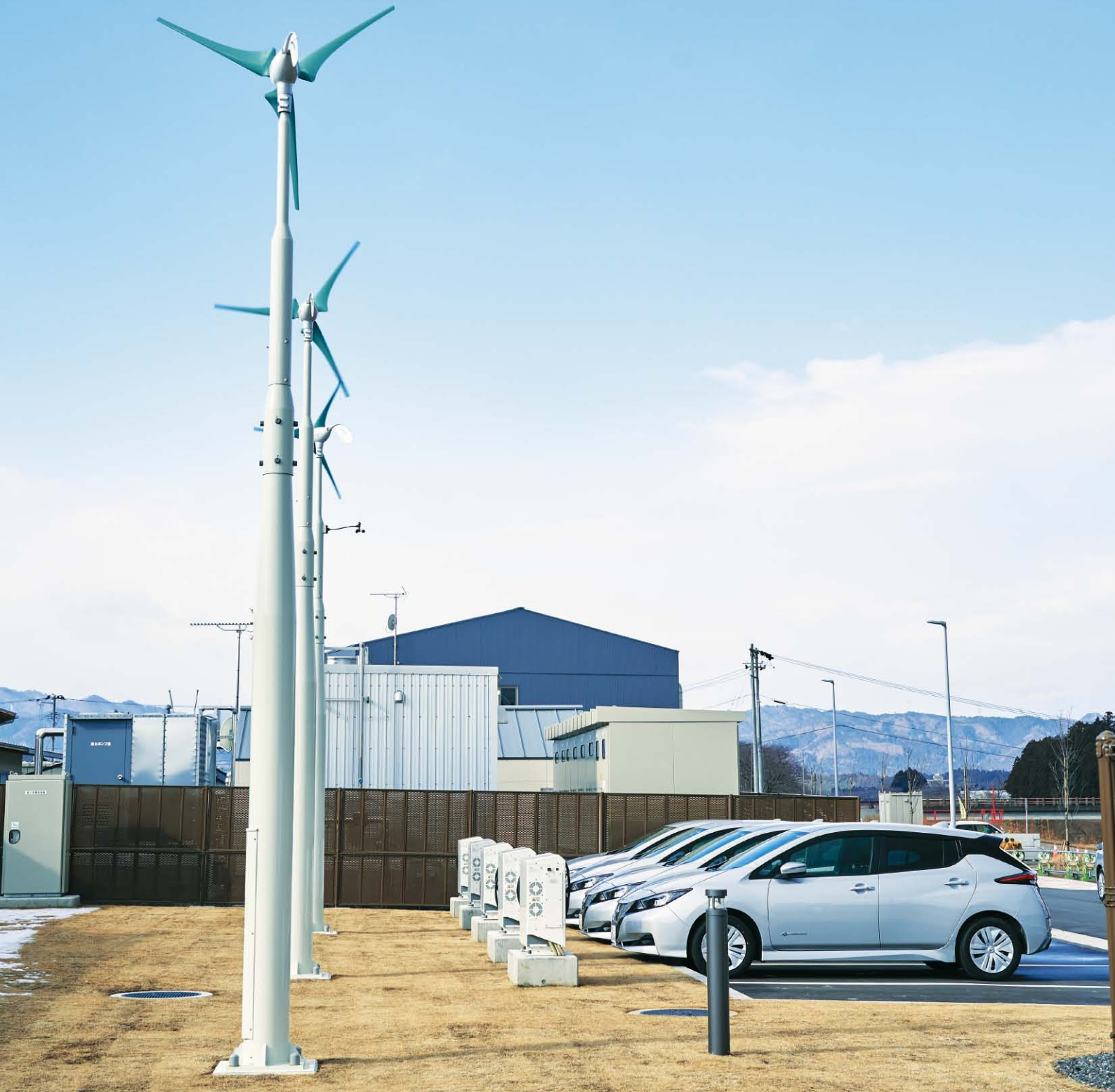
道の駅なみえに設置された風力発電。傍には、電気自動車用の充電施設も設置されている
