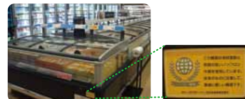
自然冷媒による冷凍ケース
