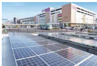
太陽光パネルを設置
