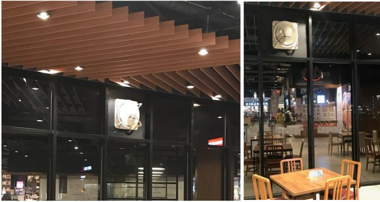
外部に面したフードコートでは、換気扇を増設し、換気をさらに促進しています。 イオンモール幕張新都心
