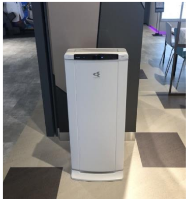
高性能空気清浄機の設置による空気浄化促進。 イオンモール高知
