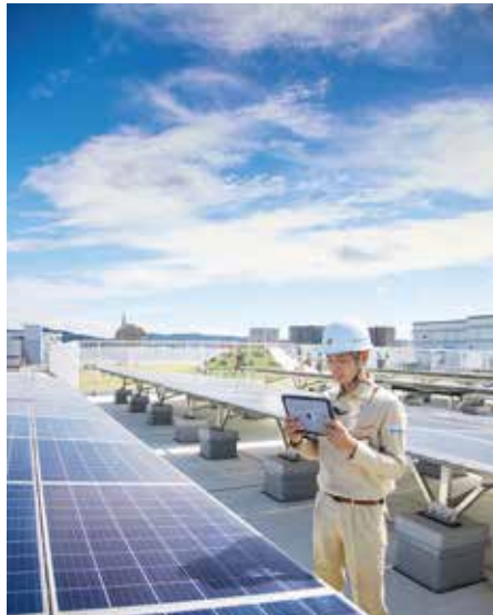
設備管理者が最新技術を活用して効率的な設備運営を行っています。イオン藤井寺ショッピングセンターでは一般家庭約30世帯の年間使用相当電力が発電できます。
