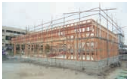
コンビニエンスストアとして日本で初めて「FSC®認証」を取得した店舗を出店（ミニストップ）
